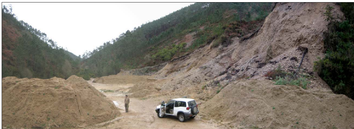
Fig. 3.7.10: Vista general de la zona de acopios y parte de los taludes de la cantera “Monte Forcón”.
