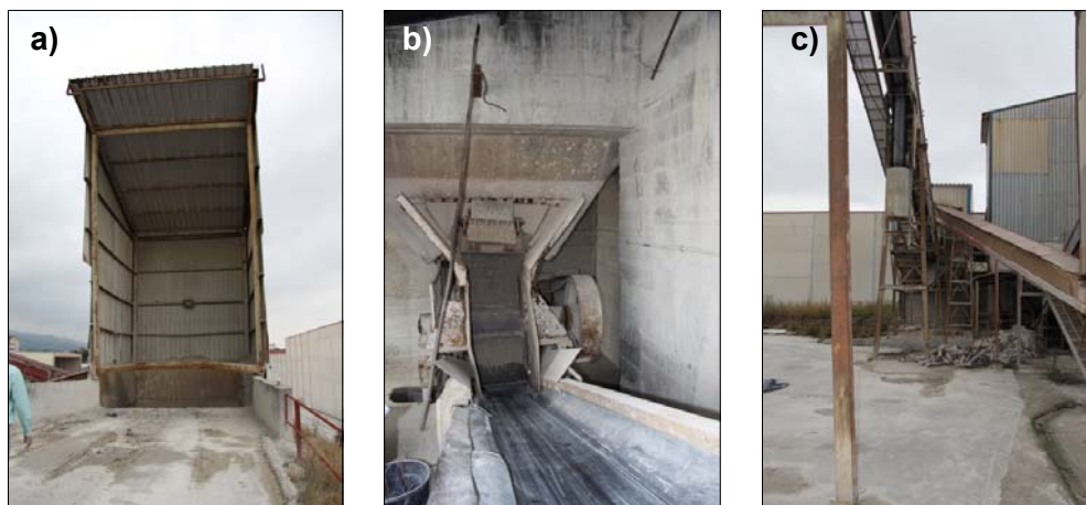
Fig. 4.2.10: a) Tolva de recepción de caolín para su posterior molienda y cribado. b) Zona de escogido de la planta de tratamiento para la separación de impurezas. c) Cintas de trasponte del material desde la tolva de recepción a la tolva prehorno.
