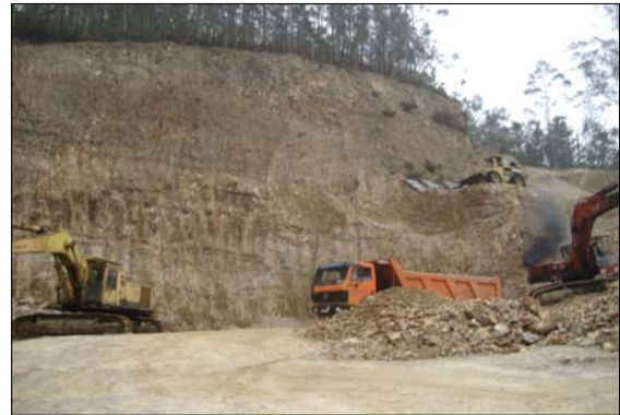
Fig. 3.3.6: Aspecto general del frente de explotación de la cantera "Las Paleiras" (Vegadeo, Asturias).
